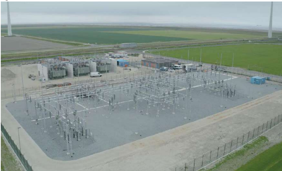
Figuur 4.5 Voorbeeld HS-station
